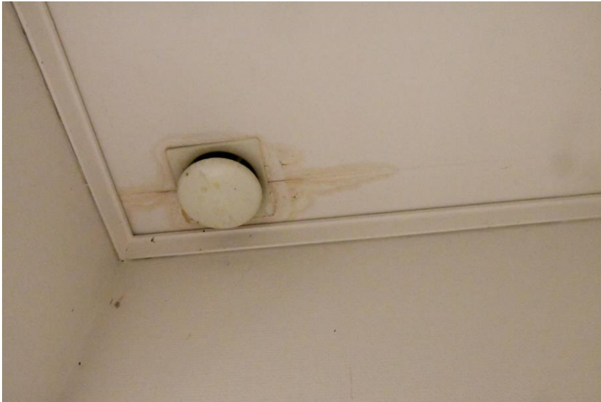
Fuktfläck i tak
