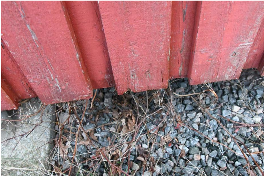
Fasad färgflagar och en del panelbrädor är rötskadade
