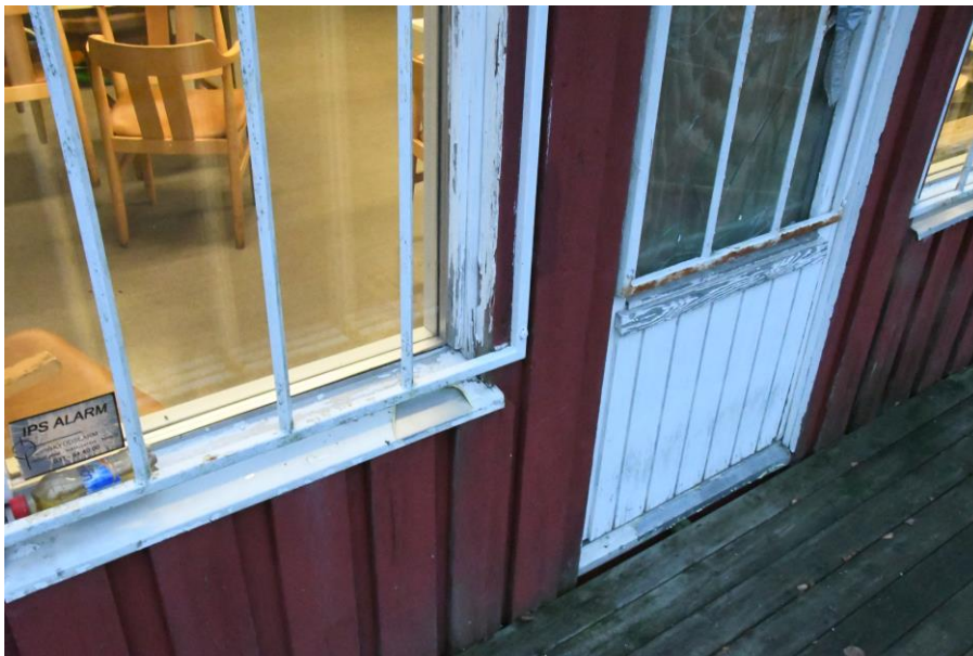
Färgflagning på fönster, fönsterbleck och dörr
