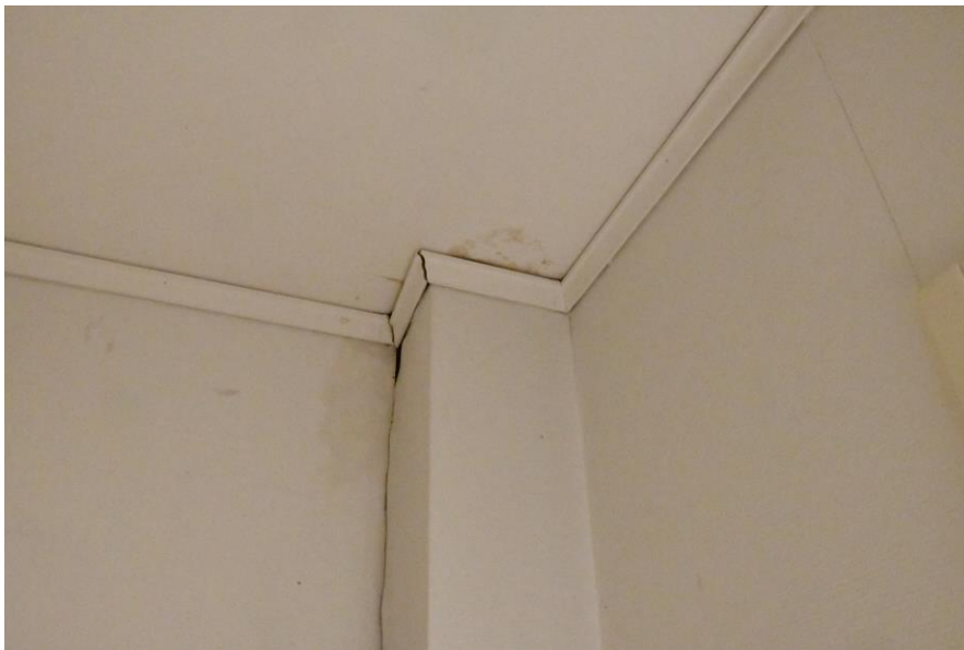
Fuktfläck i tak
