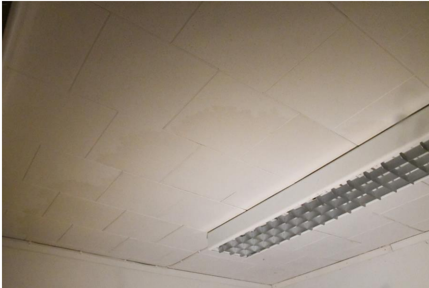
Fuktfläck på undertaksplattor
