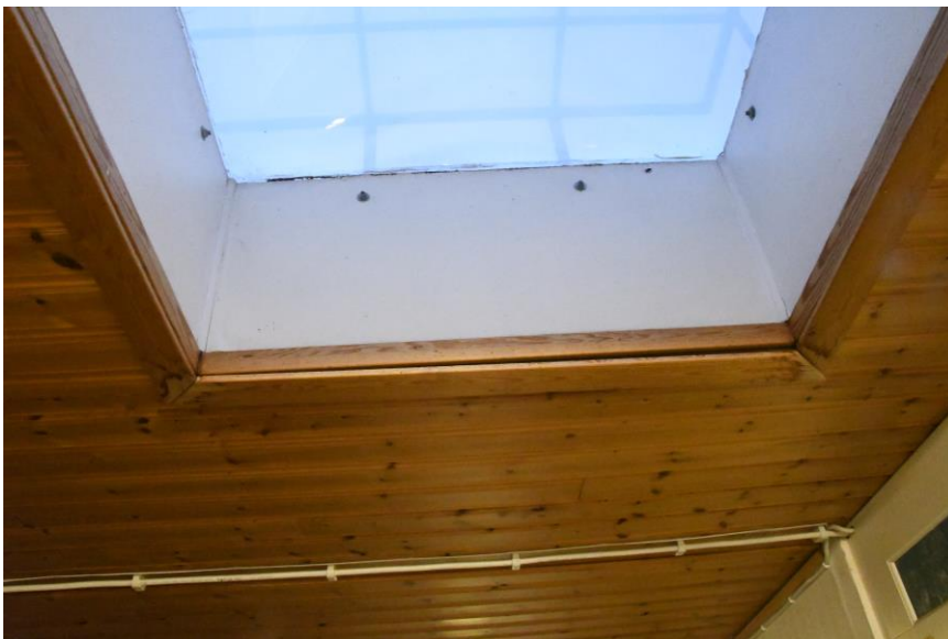
Fuktfläck i tak vid sarg till takkupol
