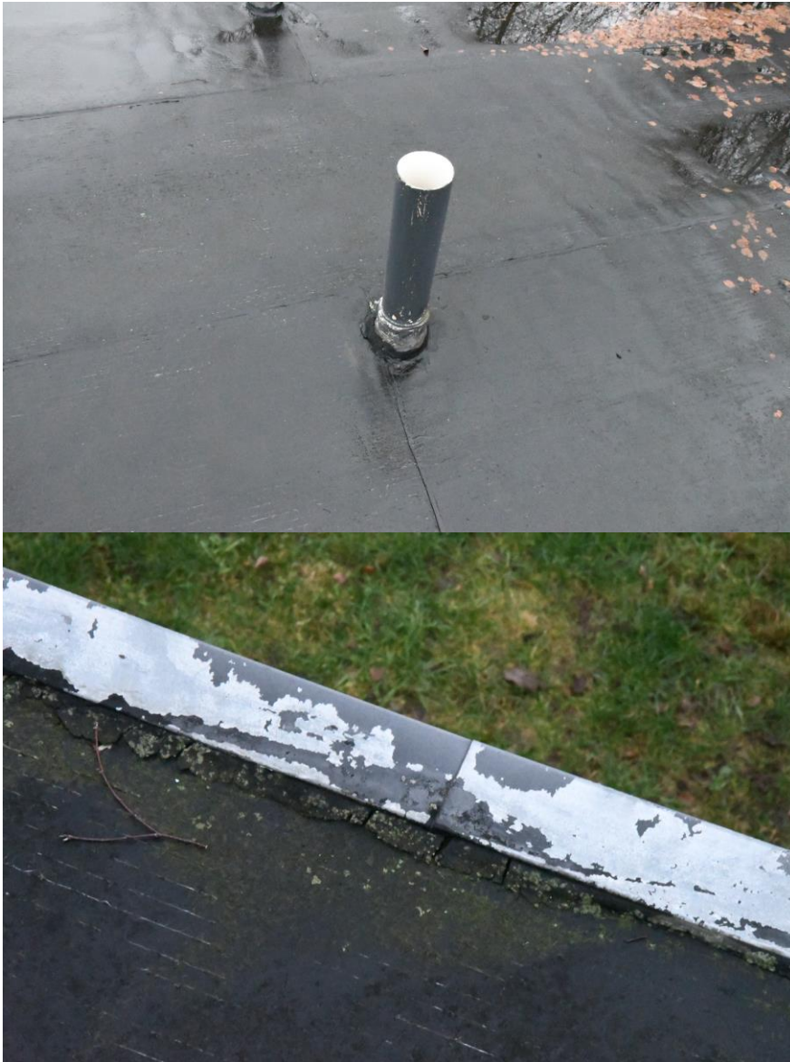
Takpappen har uppnått sin tekniska livslängd. Plåtbeslagningen färgflagar.
