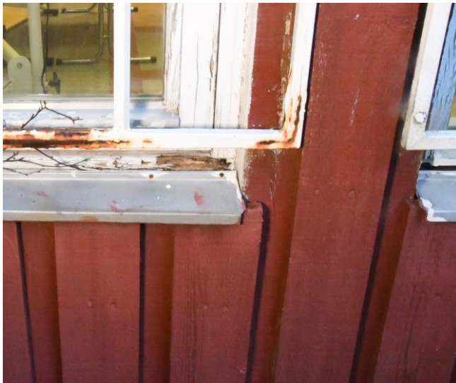
Fönster mot väster har omfattande rötskador och förmodligen finns det följdskador inne i fasaden.
